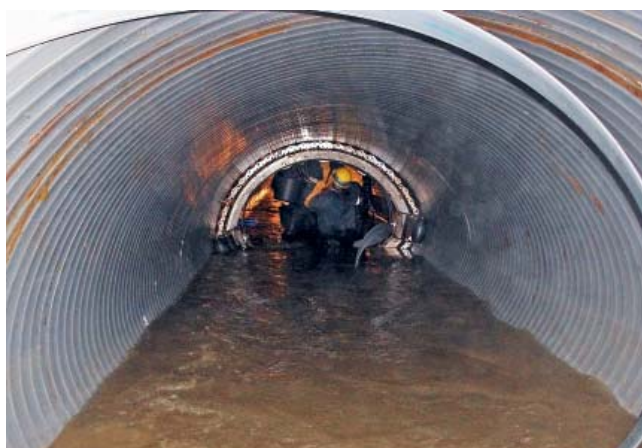
Fot. 9. A ścieki płyną
